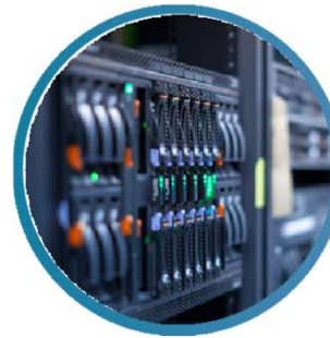
SAI Data Center (Server)
